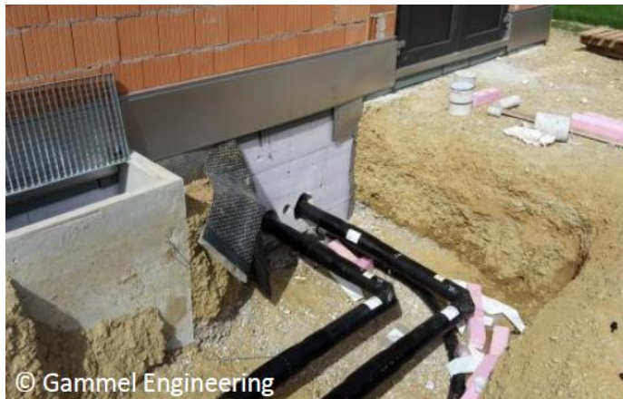
Hausanschluss von außen bei Zweirohrsystem
