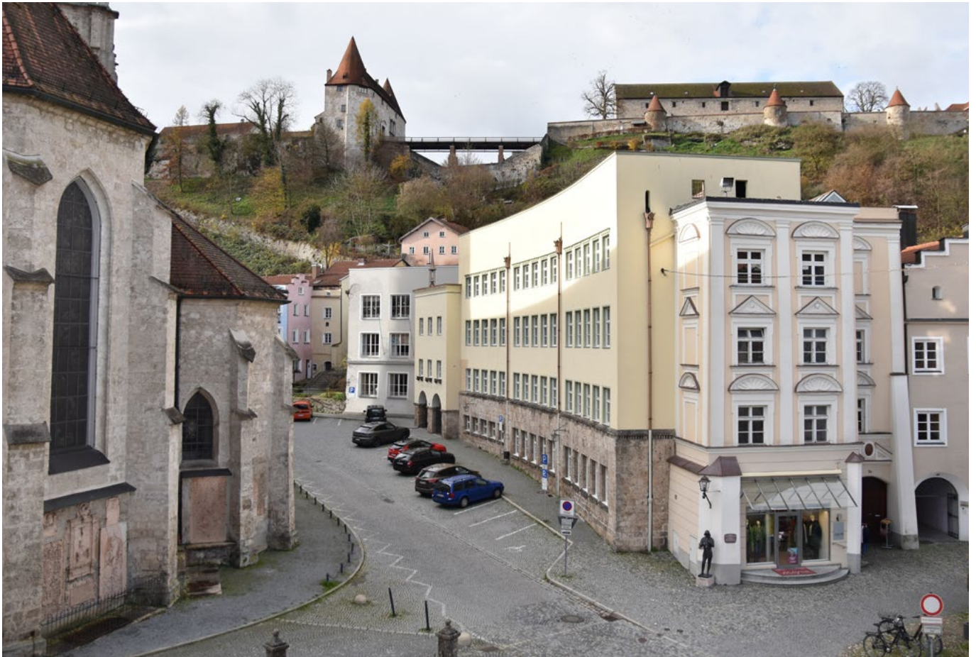
Ein Juwel mit fast 500-jähriger Geschichte: Im Zuge der Bauarbeiten wird die ursprüngliche Fassade der Hans-Stethaimer-Schule gegenüber der Pfarrkirche St. Jakob so weit machbar wieder hergestellt
