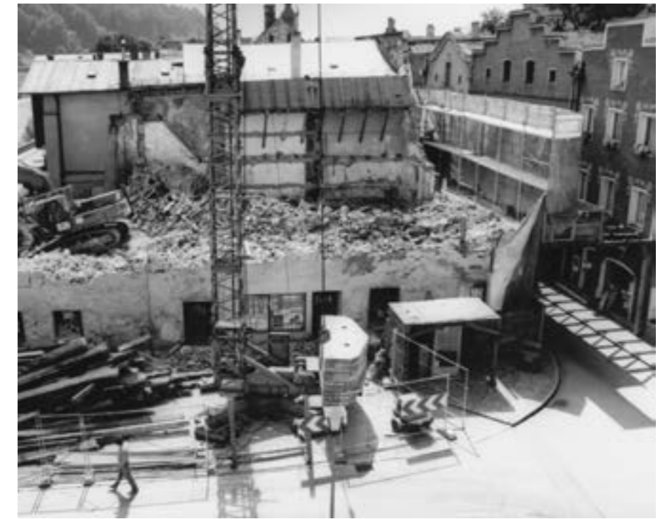
Platz für Neues: 1984 wurden das marode Gebäude Gruben 170 abgerissen, nachdem drei Jahre zuvor ein Feuer das Haus schwer beschädigt hatte
